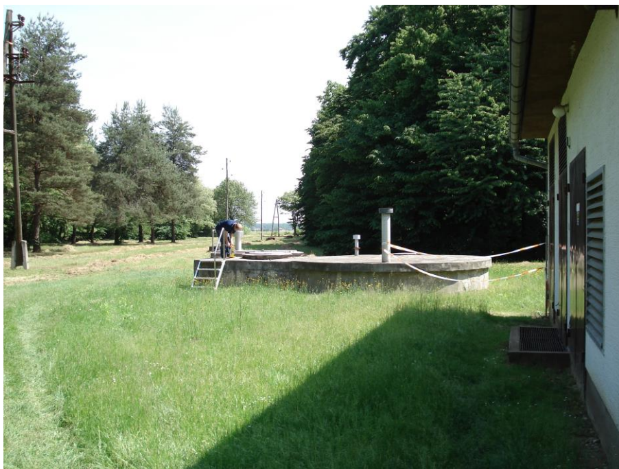
Slika 1. Črpališče vodovoda Murske Sobotе – maj, 2010
