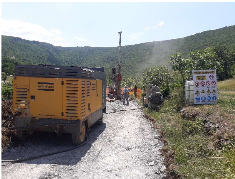
Slika 2. Vrtanje vrtnice v prispevnem zaledju Rižane z namenom nadzora in varovanja vodnega vira pitne vode; julij 2019
