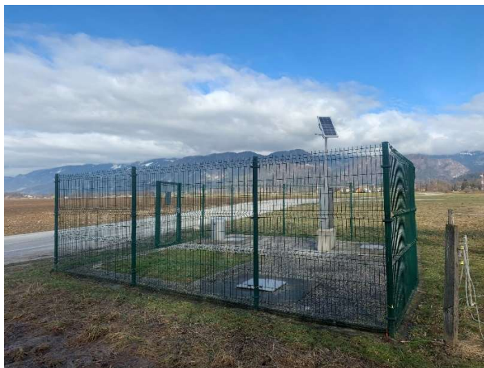
Slika 2. Objekt za spremljanje stanja podzemnih voda na območju Radovljice, februar 2021 Figure 2. Groundwater monitoring object in Radovljica, February 2021
